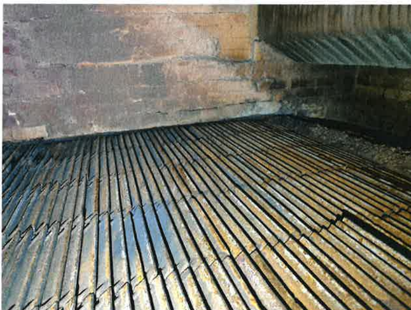
Ściana boczna przeznaczona do remontu
