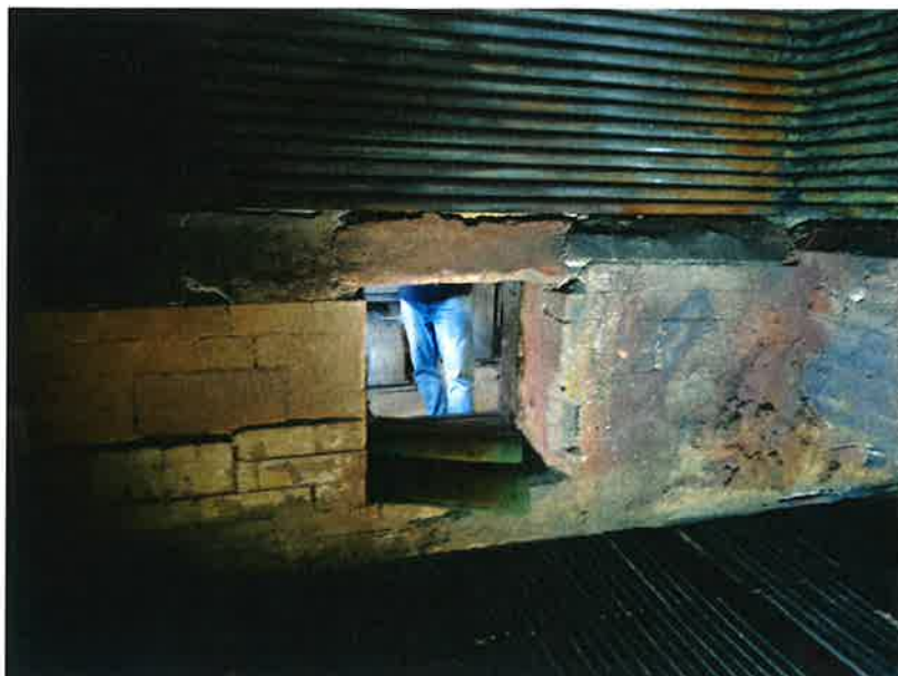
Okno rewizyjne komory paleniskowej
